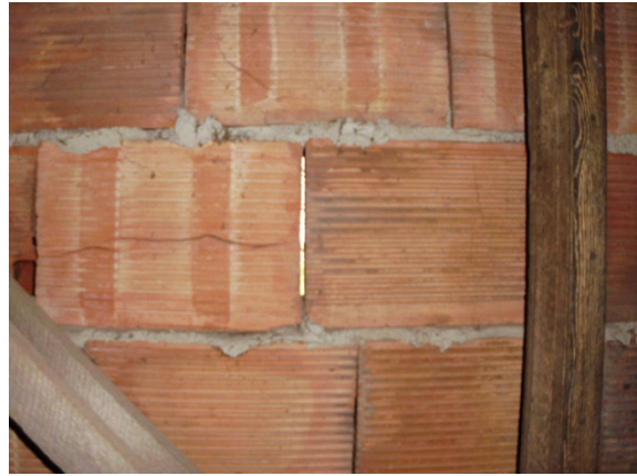
Abbildung 27: Spalten in Ziegelmauerwerk
