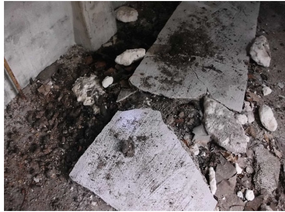
Abbildung 33: Waschbär-Kotspuren finden sich in allen Dachbereichen
