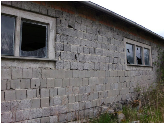
Abbildung 28: unverputzte Wände mit vielen Spalten und Ritzen
