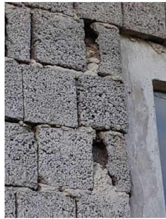
Abbildung 29: Nischen in verwaschenen Hohlblocksteinen
