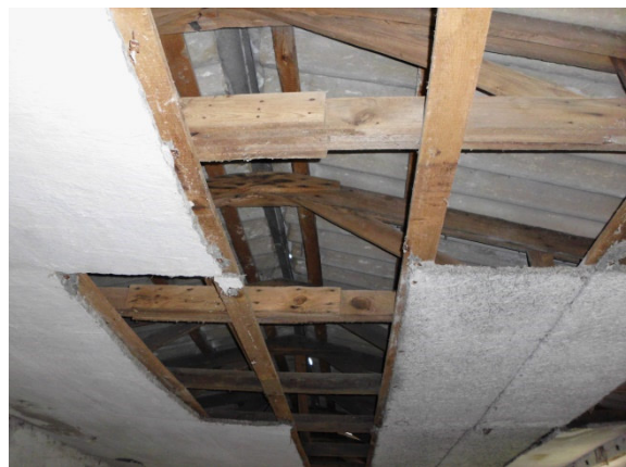
Abbildung 31: abgefallene „Sauerkohlplatten“, dadurch Dachbereich gut zugänglich
