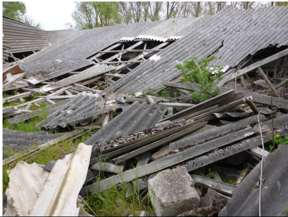
Abbildung 9: Eingestürztes Dach des Gebäudes G3
