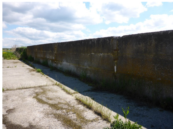
Abbildung 14: Betonfläche (Silo) B3
