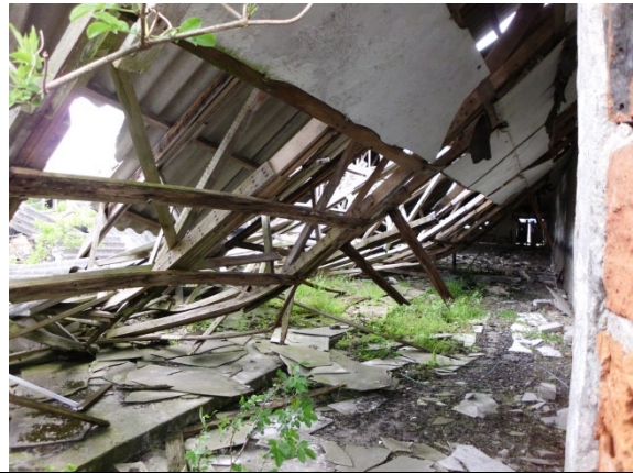
Abbildung 10: Innenansicht des eingestürzten Gebäudes G3
