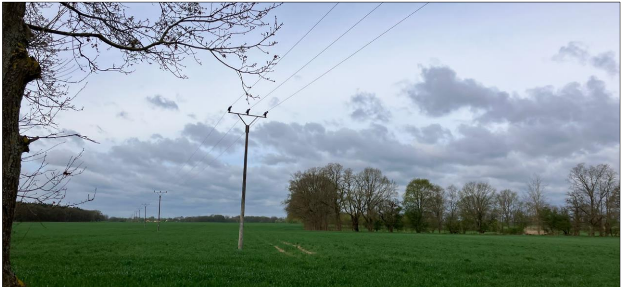
Abb. 22 Stromleitungen in Teilgeltungsbereich Nord
