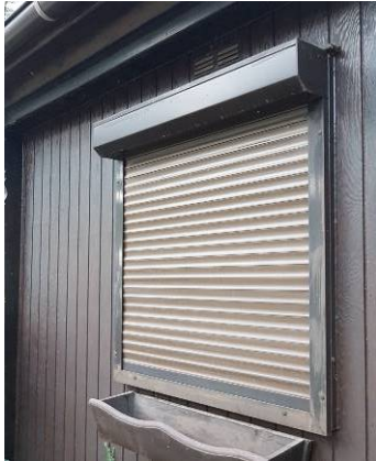
Bungalow Nordteil, hier mit Quartiermöglichkeit im Bereich eines Jalousiekastens
