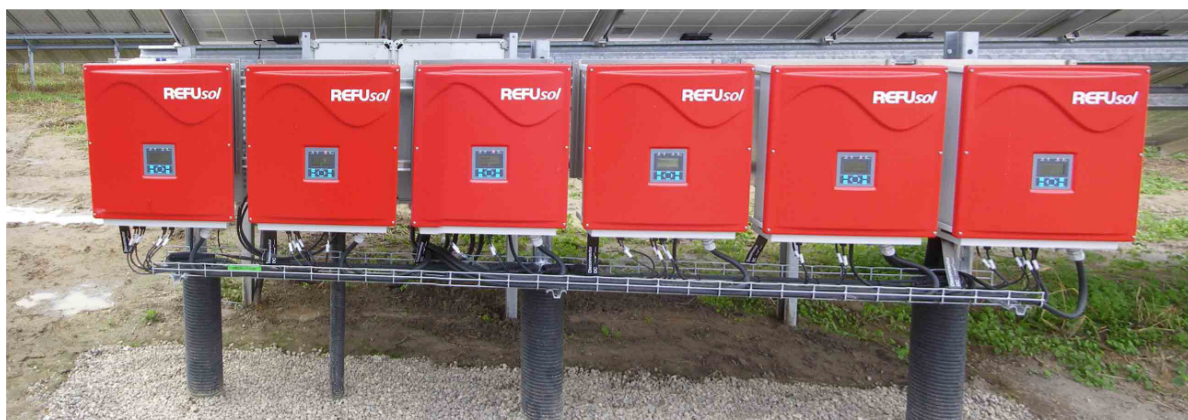
Abb. 24: Beispiel für eine unter den Modultischen stehende Wechselrichteranlage aus sechs einzelnen Wechselrichtern, hier Solarpark Kremmen. (Foto RIK: P7120004-05)
