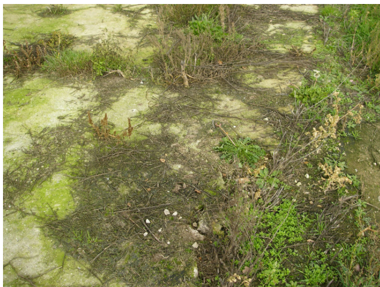
Abb. 16: Beispiel für eine von Pionierpflanzen aufgebrochene Betonfläche (OCA-Fläche). (Foto RIK: PA210128+133.JPG)
