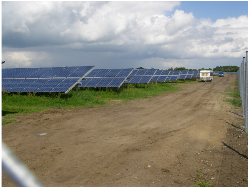
Abb. 20: Beispiel für Modulreihen einer Freiflächen-Photovoltaik-Anlage, hier Solarpark Kremmen. (Foto RIK: P7120018.JPG)
