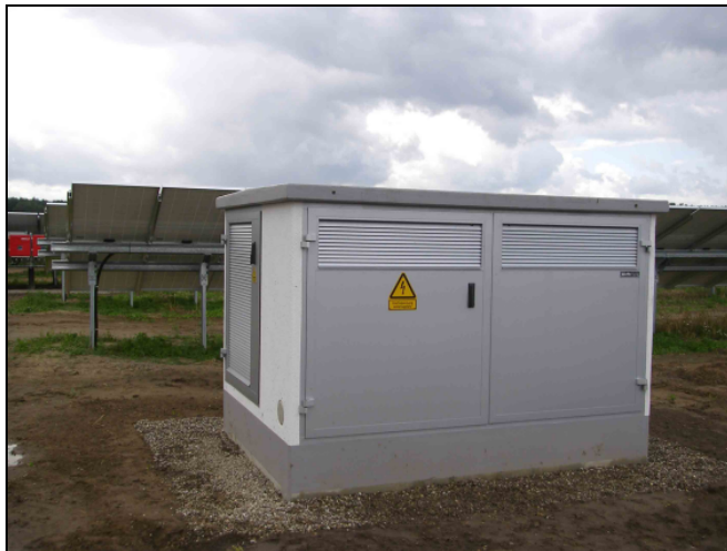
Abb. 25: Beispiel für einen Transformator, der den Wechselstrom von 400 V auf 20 KV hochtransformiert, hier Solarpark Kremmen. (Foto RIK: P7120014.JPG)
