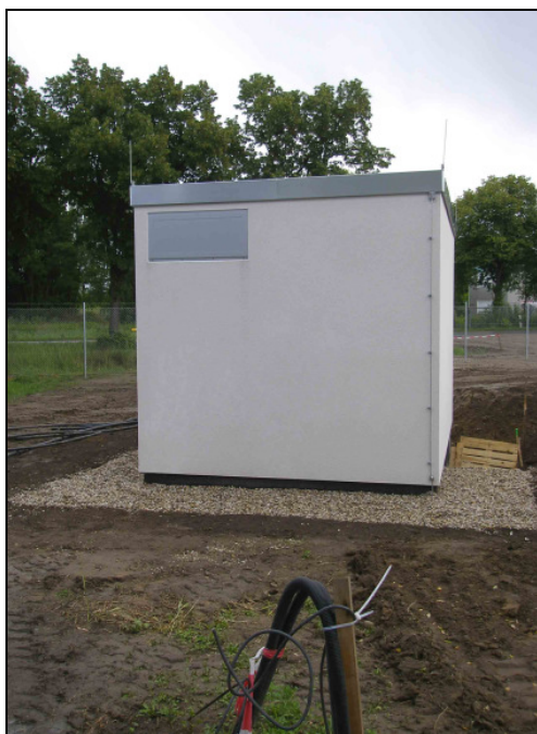
Abb. 26: Beispiel für eine Mittelspannungsschaltstation 20 KV, hier Solarpark Kremmen. (Foto RIK: P7120016.JPG)
