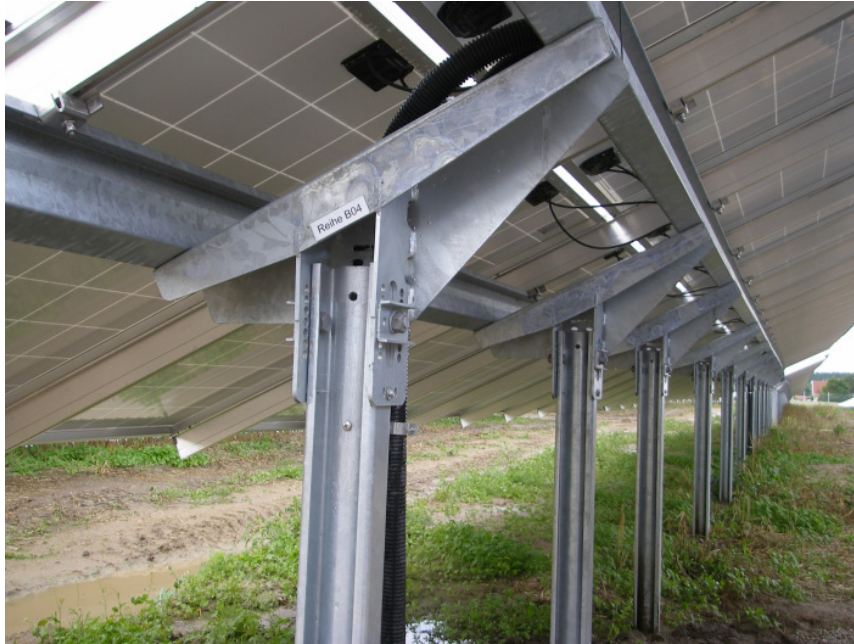
Abb. 22: Unterkonstruktion der Photovoltaik-Module mit nur einer Mittelstütze, hier Solarpark Kremmen. (Foto RIK: P7120001)
