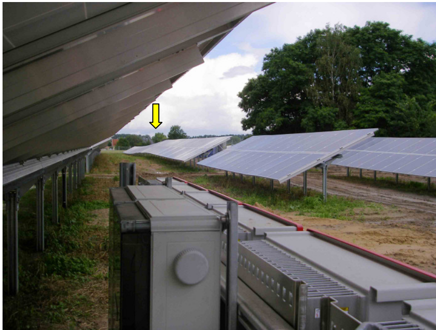
Abb. 28: Beispiel aus dem Solarpark Kremmen für die höhenmäßige Anpassung der Modulreihen an das Gelände. Der Pfeil zeigt eine Verwerfung, die für die Funktionstüchtigkeit der Photovoltaikmodule ohne Bedeutung ist. (Foto RIK: P7120009.JPG)
