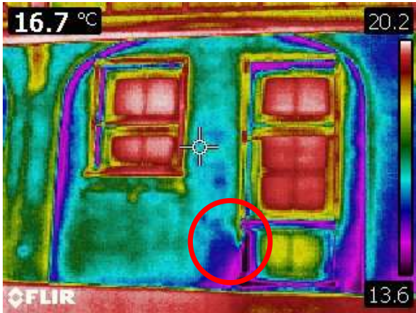
Abbildung 17: Undichtigkeit an einem Fenster (siehe roter Kreis)
